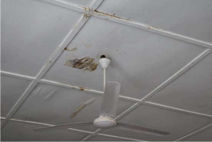
El techo del aula de cocina, a punto de ceder
